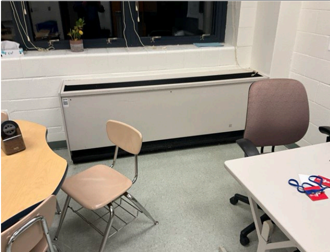
19 - FAN COIL UNITS
